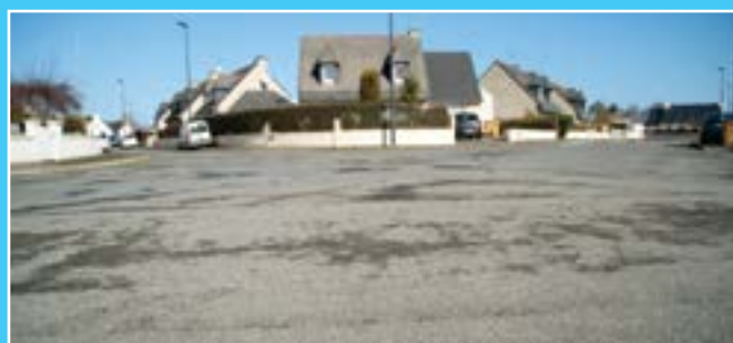
Les travaux de réfection de voirie du lotissement des Grèves démarreront après l'été. Coût : 409 000 € TTC
